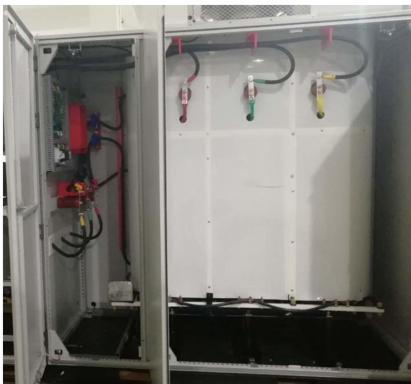
Рисунок 2.5. Внешний вид шкафа трансформатора с открытой дверью
